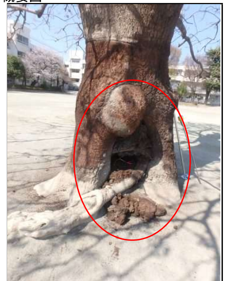
写真3 幹、根元: 樹皮枯死、樹皮欠損、腐朽 根元: 開口空洞、腐朽
