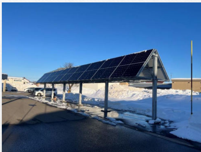
民間企業：駐車場設置（23.2kW）
