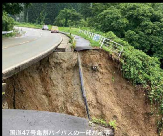
国道47号亀割バイパスの一部が崩落
