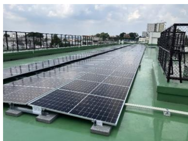
太陽光発電パネルの例
