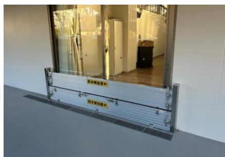
出入口に止水板を設けた例 (瀬田小学校)
