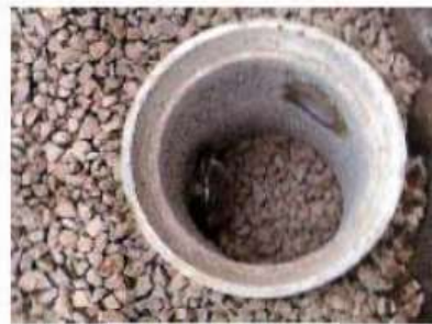
雨水浸透ます
