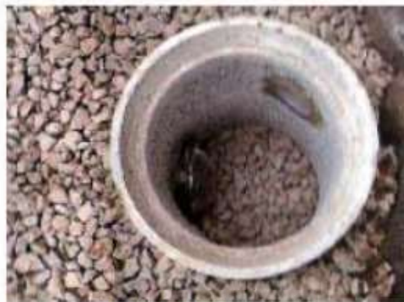
雨水浸透ます
