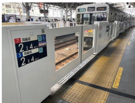
写真 4-7 可動式ホーム柵
