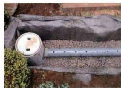
浸透(トレンチ)管
