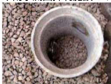
雨水浸透ます
