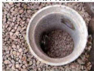
雨水浸透ます
