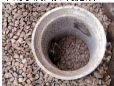
雨水浸透ます
