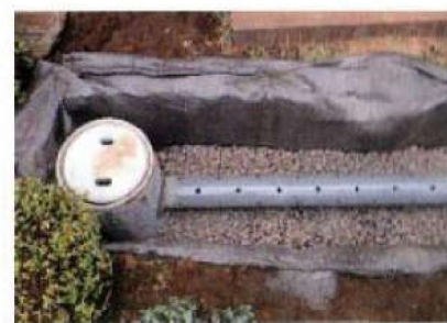
浸透(トレンチ)管
