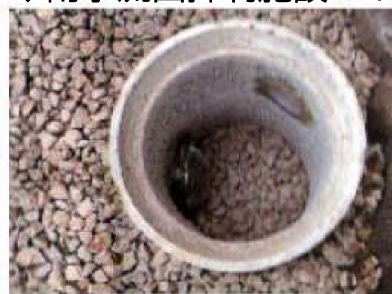
雨水浸透ます
