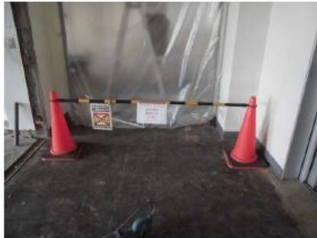
立入禁止措置
