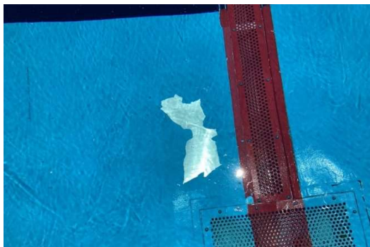
大きな塗装の剥がれ
