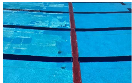
細かな塗装の剥がれ
