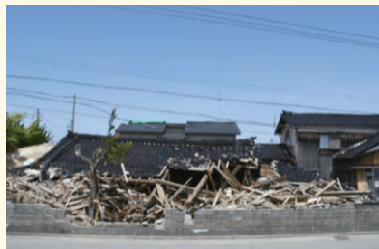
▲(珠洲市内)倒壊家屋の撤去がいまだに進んでいない状況
