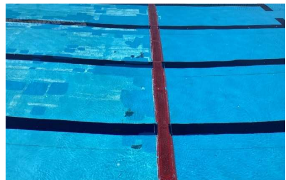
細かな塗装の剥がれ
