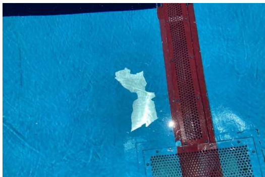
大きな塗装の剥がれ
