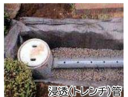
雨水浸透ます
