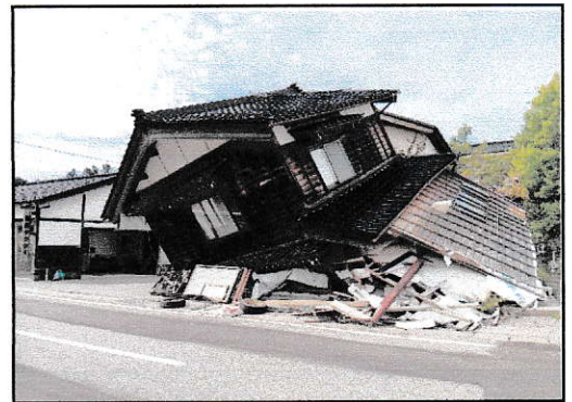
輪島市門前町の倒壊家屋
