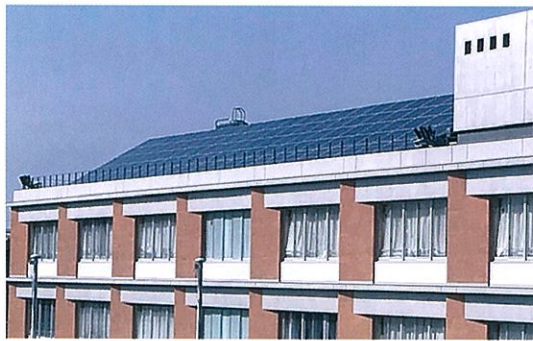
小学校に設置された太陽光パネル
