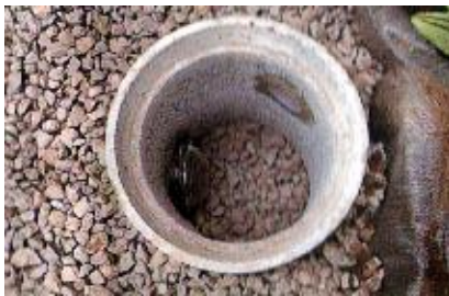
雨水浸透ます
