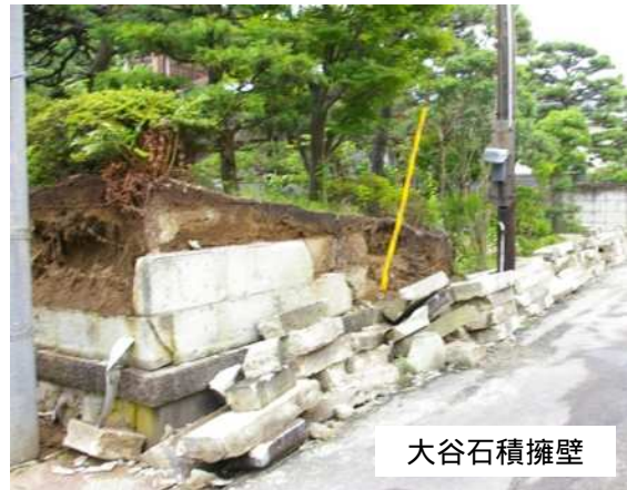
被災事例（新潟県中越沖地震）
