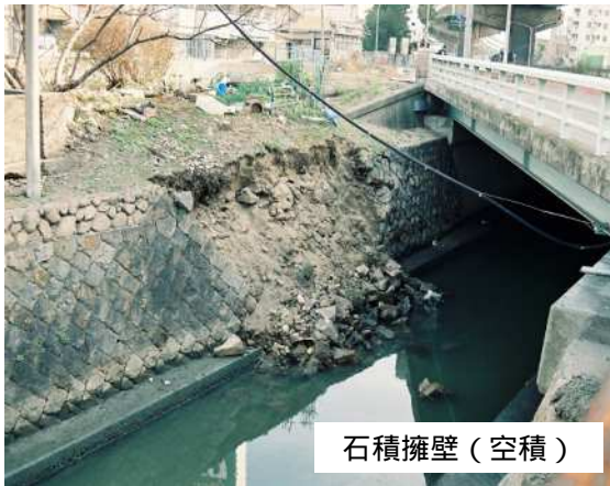
被災事例（兵庫県南部地震）
