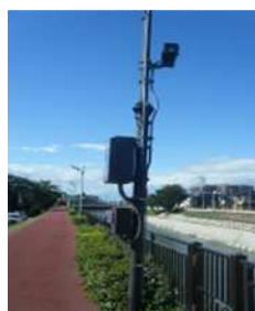
ライブカメラの設置状況(平成 21 年 10 月)
