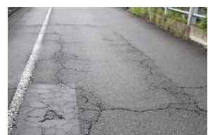
ひび割れ率=25%の状態
