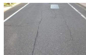
ひび割れ率=20%の状態
